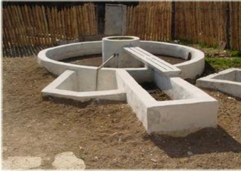
Biodigester construido en una cooperativa agropecuaria, Ciego de Ávila, Cuba
